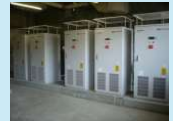
図2（蓄電池システム）
