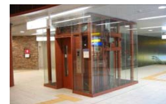
エレベーター
