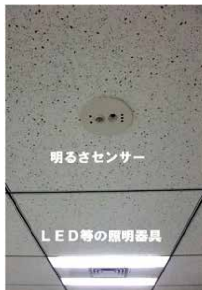
<ビル内のLED照明採用事例>
