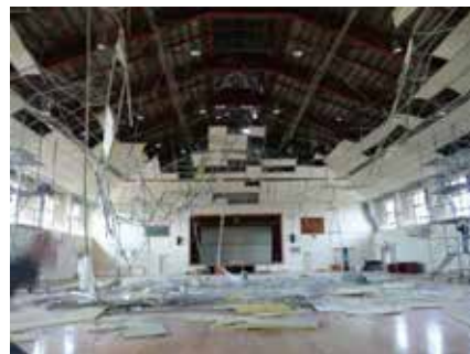
＜東日本大震災の被災地における 体育館の天井落下被害＞
