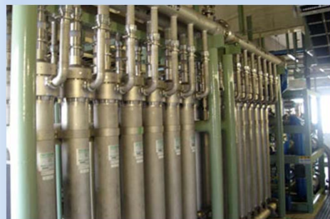
オゾン発生装置
