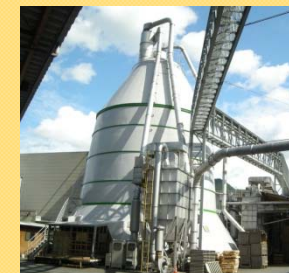
木質バイオマス発電
