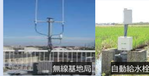
無線基地局 自動給水栓
