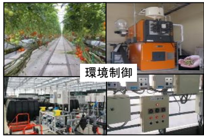
● 高度環境制御装置
