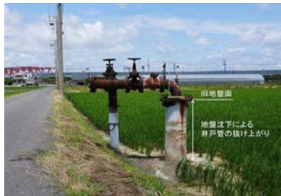
地下水揚水に伴う地盤沈下 三重県木曾岬町累積117cm (S36~H27)
