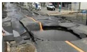
大阪府北部を震源とする地震における送水管の破損現場
