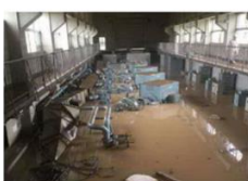
浸水被害を受けたポンプ施設
