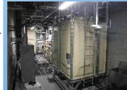
地下水処理設備
