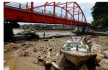
港湾への土砂流入 (熱海港伊豆山地区)
