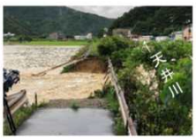
沼田川水系天井川の堤防決壊 (広島県三原市)
