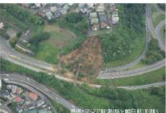
遠子ICにおけるり面崩落 (神奈川県遠田市)
