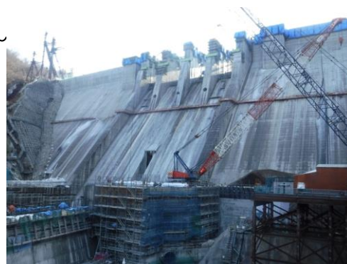
ハッ場ダムの堤体打設状況(群馬県) (コラム6より) 資料)国土交通省
