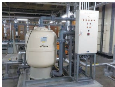
ろ過装置（地下機械室）
