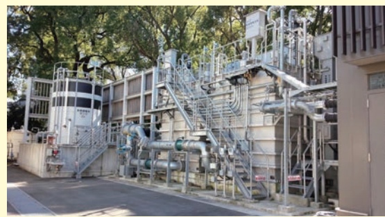
写真2-7 皇居外苑濠水浄化施設（東京都千代田区）
