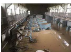
浸水被害を受けたポンプ施設
