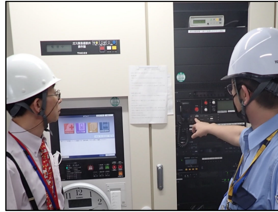
防災・保安センターにおける 火災警報装置の確認
