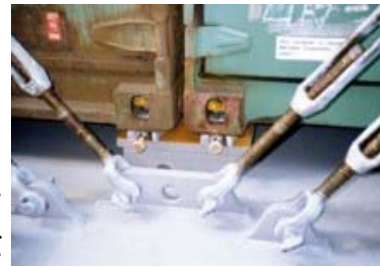
コンテナの流出防止対策 (固縛設備)
