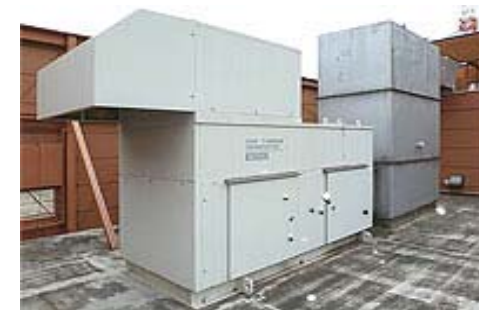
(非常用自家発電装置)
