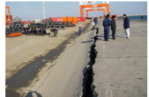
非耐震強化岸壁背後の陥没
