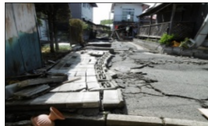
〔倒壊したブロック塀〕
