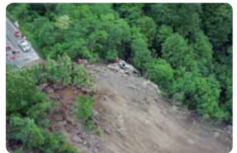
2008年／岩手・宮城内陸地震／湯浜温泉斜面崩落現場（仙台市消防局）
