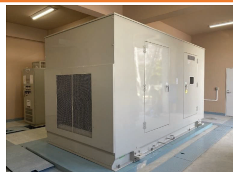
非常用自家発電設備
