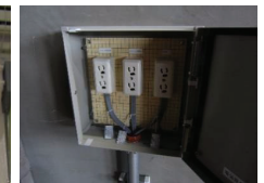
非常用コンセント
