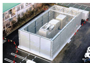
非常用自家発電設備(全景)
