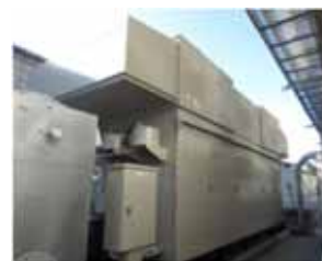
大規模商業施設の停電対応施設 (埼玉県さいたま市)
