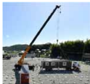
モバイルハウスを 利用した仮設住宅 (岡山県倉敷市)
