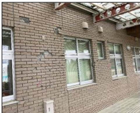
外壁（タイル）の落下
