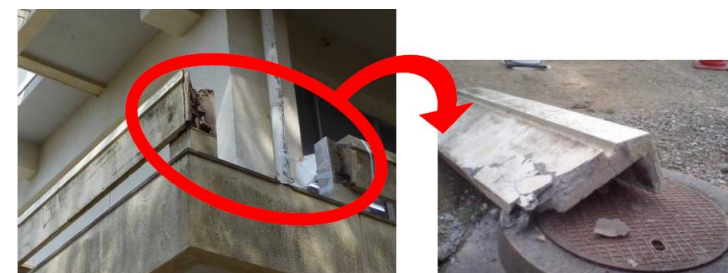
平常時に、老朽化により手すりが落下
