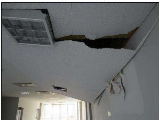
天井材の落下
