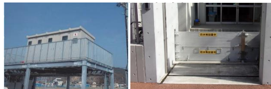
受変電設備のかさ上げ
