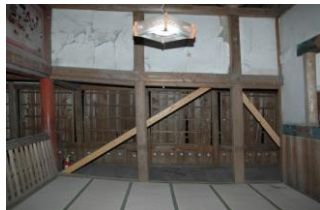
本堂内部(修理前) 東日本大震災で被災し、柱が傾斜
