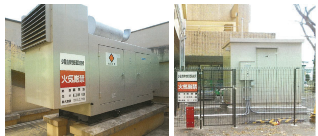
非常用自家発電設備本体
