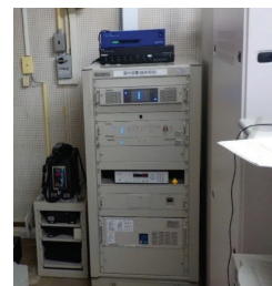
衛星通信装置(白石市庁舎)
