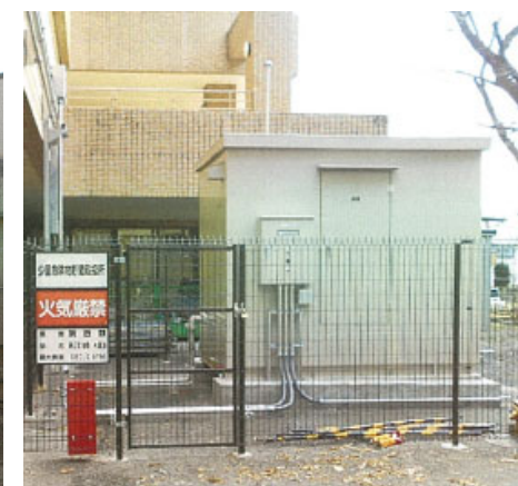
非常用自家発電機用 燃料タンク
