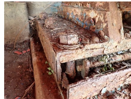
支承の腐食、アンカーボルトの欠損
