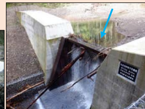
土石流発生後
