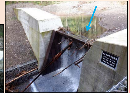
土石流発生後
