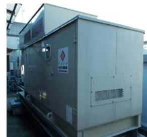
(非常用自家発電装置)
