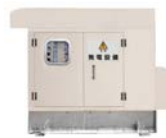
非常用発電設備
