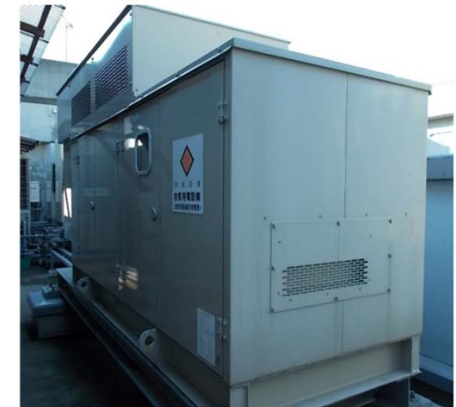
(非常用自家発電装置)
