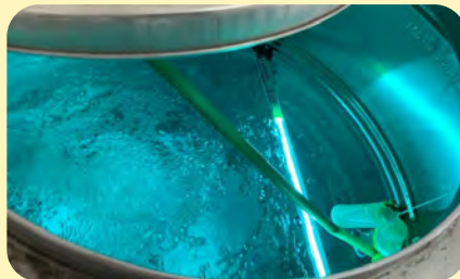
エンジニアらによってRO水タンクに設置された殺菌灯
