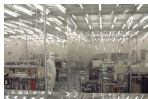
クリーンルーム
