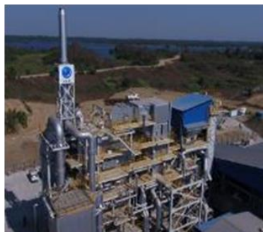
廃棄物発電施設 @ミャンマーヤンゴン市
