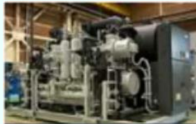
高効率冷凍機
