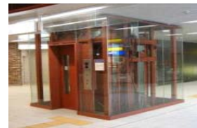
【エレベーター】
