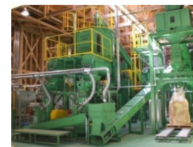
木質ペレット工場
