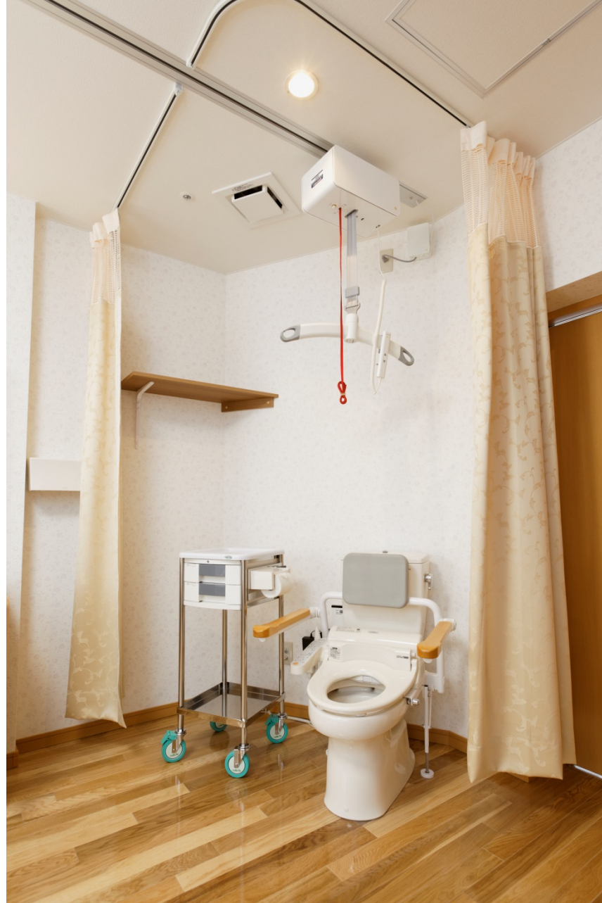
天井走行リフト(居室内トイレ)
