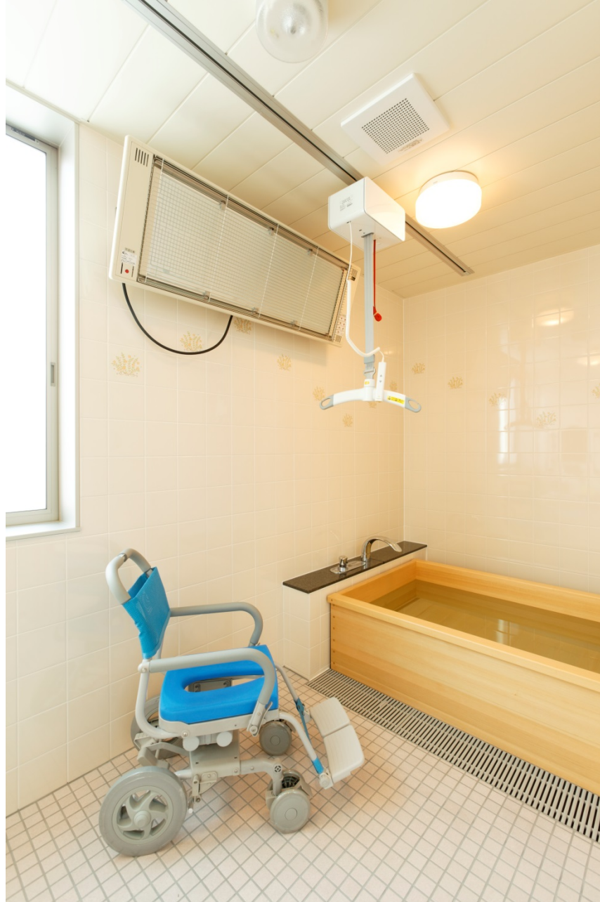
天井走行リフト（浴室内①）
