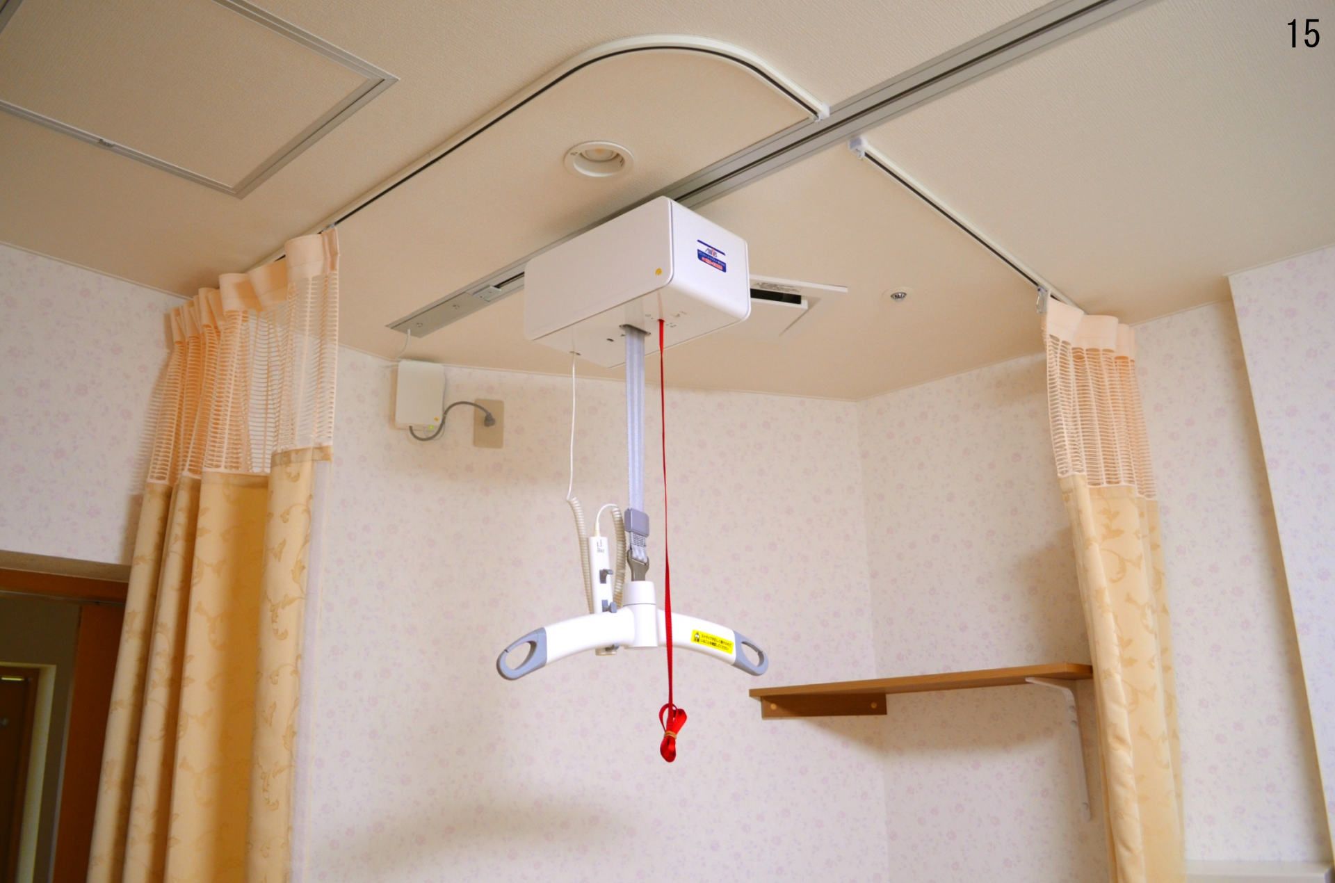
天井走行リフト(拡大)
