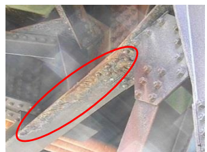
耐候性鋼材に層状の剥離
