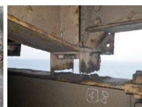
▲シェッド主梁端部破断
