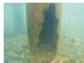
▲橋脚水中部の断面欠損
