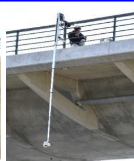
点検用 ロボット カメラ
