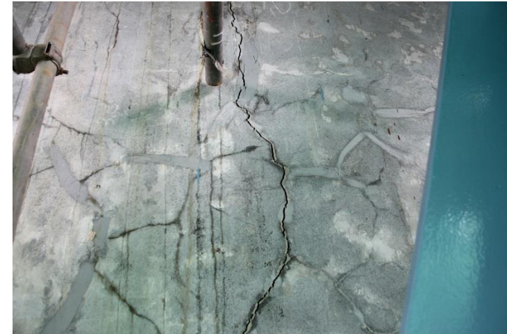
補修後、数年で、再劣化
