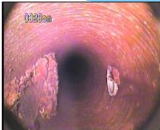
管内堆積状況
