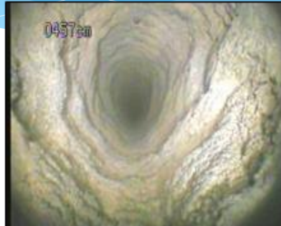
管内閉塞状況
