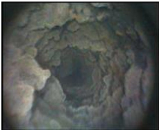
管内錆瘤発生状況
