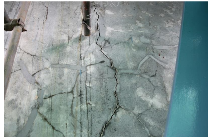
補修後、数年で、再劣化
