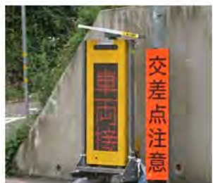
路車連携型表示板の設置による安全確保
