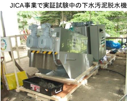
JICA事業で実証試験中の下水汚泥脱水機
