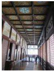
経年劣化によって剥落した天井画
