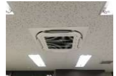
換気設備の導入
