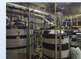
① D:スケールアップしたレアアースの酸抽出槽
