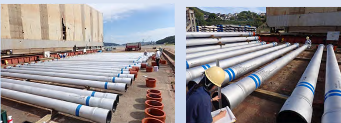
揚泥管・浮力材
