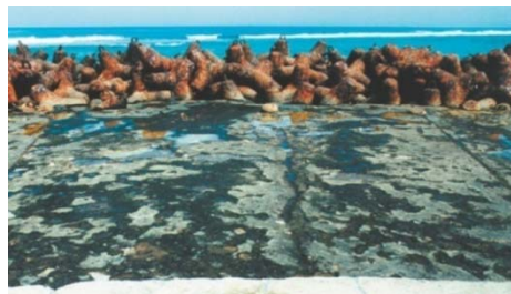
護岸コンクリート部の劣化
