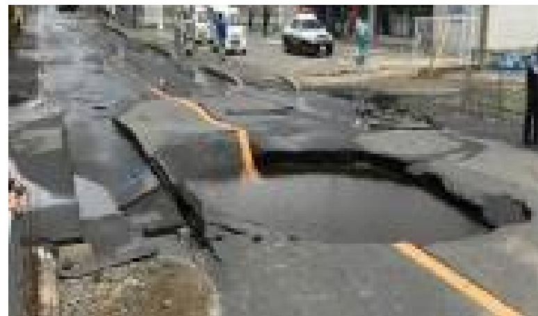
大阪府北部を震源とする地震における送水管の破損現場
