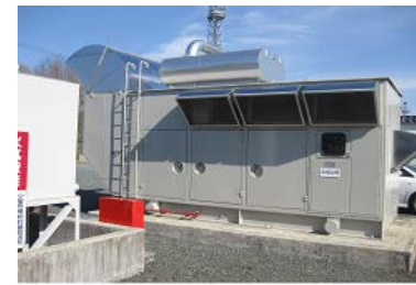
長時間連続運転仕様 自家発電設備
