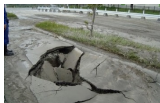
地震により液状化する臨港道路
