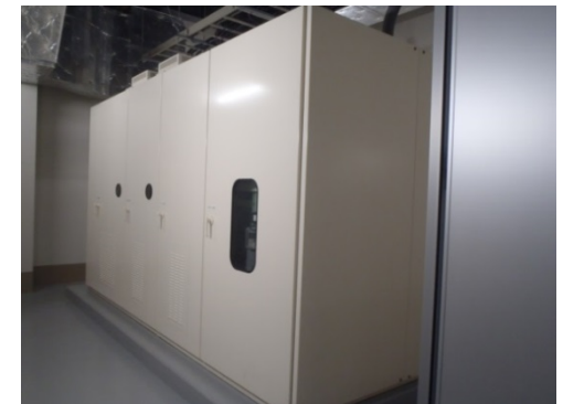
電源施設の浸水対策 (2階に設置)
