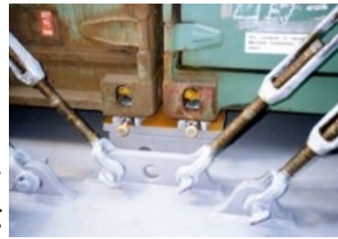
コンテナの流出防止対策 (固縛設備)
