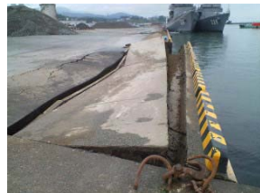
地震により被災する岸壁
