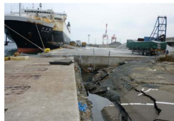
非耐震強化岸壁背後の陥没
