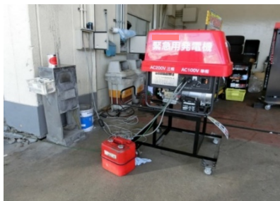
SSの配電盤に接続された自家発電設備
