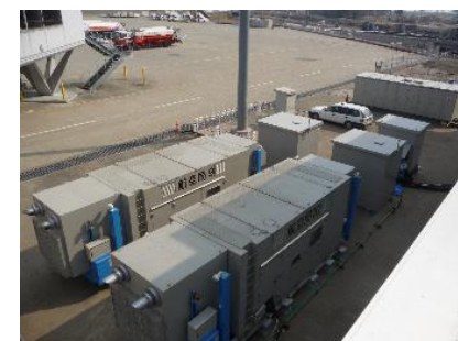
<可搬型発電装置>
