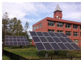
避難所に設置した太陽光発電
