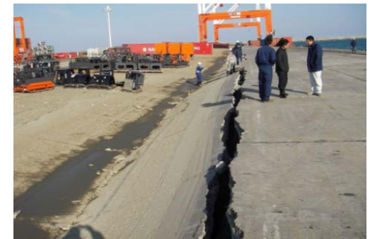
非耐震強化岸壁背後の陥没
