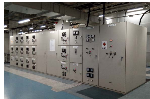
<管制施設の電源設備>
