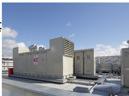
屋上に設置した自家発電設備
