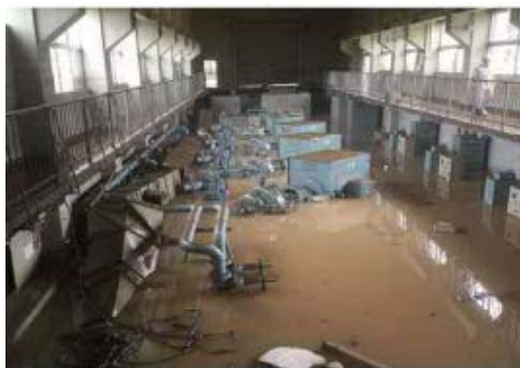
浸水被害を受けたポンプ施設
