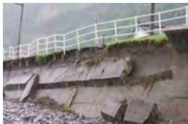
H19 新潟県中越沖地震における護岸の被災
