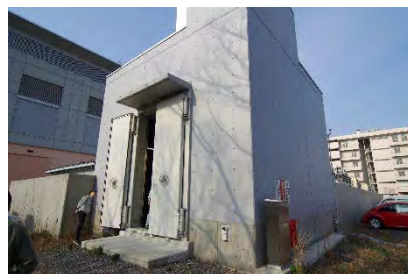
発電機室の防潮扉
