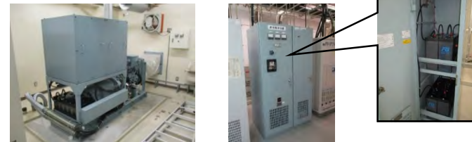
非常用電源設備
