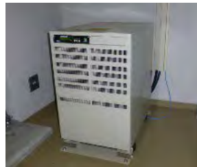
無停電電源装置
