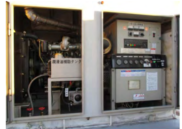
<自家発電設備>
