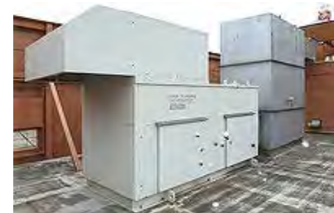
(非常用自家発電装置)
