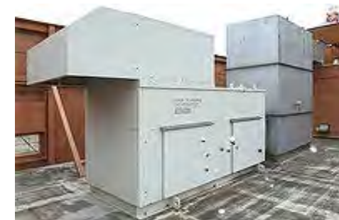
(非常用自家発電装置)
