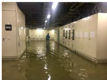
<地下電源設備の浸水被害>
