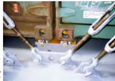
コンテナの流出防止対策 (固縛設備)
