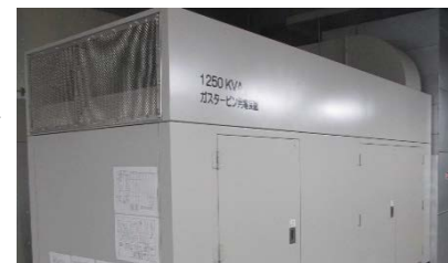
非常用電源設備
