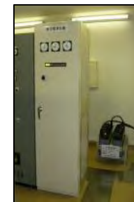
直流電源装置
