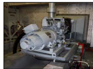
非常用発動発電機
