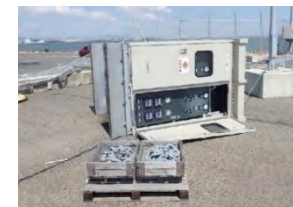
浸水した電源設備
