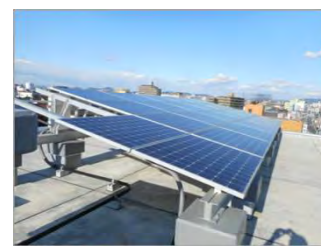
再エネ・蓄エネ等を設置した民間施設
