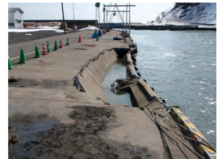
地震による岸壁の倒壊
