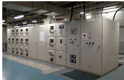
<管制施設の電源設備>
