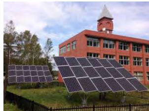
避難所に設置した太陽光発電
