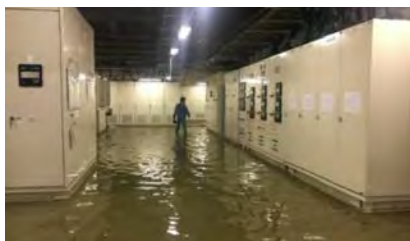
<地下電源設備の浸水被害>
