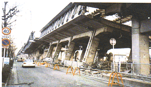
大規模地震による高架橋の倒壊事例
