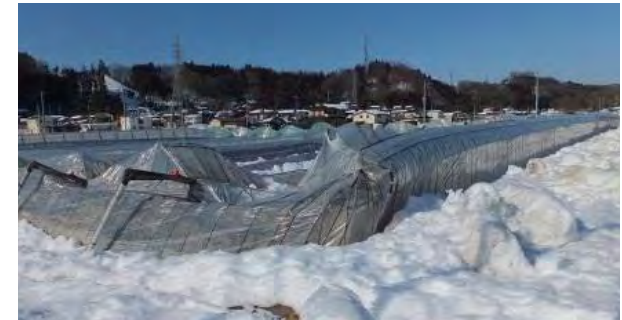
大雪により倒壊したハウス
