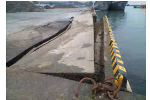
地震による岸壁の被災
