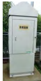
非常用発電機
