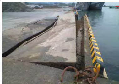
地震による岸壁の被災
